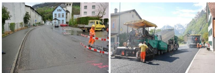
Vorbereitungen für den Probereinbau Einbau auf der gesamten Breite in der Mühlhäusernstrasse
