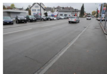
Teststrecke Goldach / SG, Zustand am 15.10.2015
