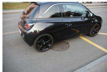
Begehung vom 23.10.2015 – Bereich gegenüber Friedhof Lugano Schachtdeckel Pamrex 600 direkt unter der Rad-Spur
